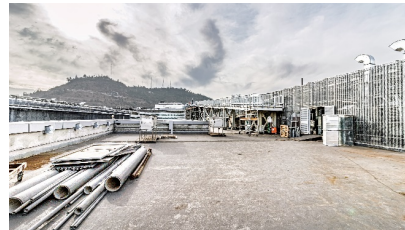
Piso Técnico HDS
