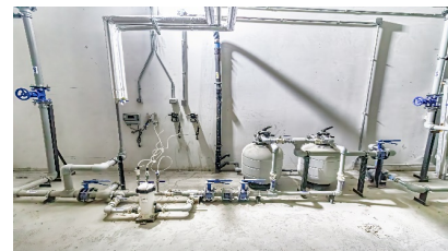
Tratamiento de agua Piletas
